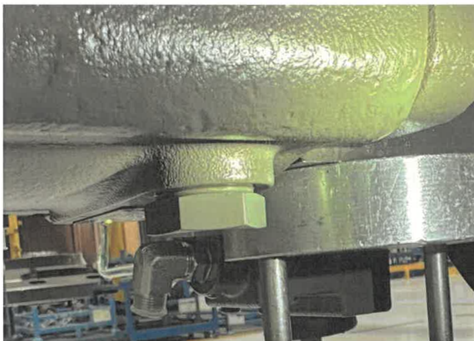
写真1 二箇所のボルトが緩み 照片1 两处螺栓松动
